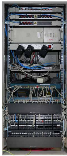
Jeden z místních rozvaděčů. Přes tento rozvaděč je připojeno CT i MR.
