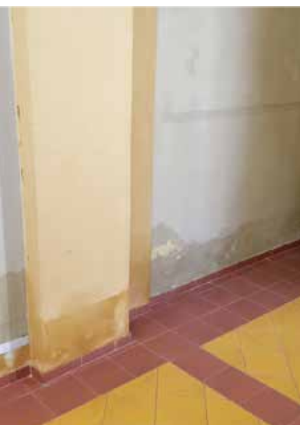
Stav před sanací
